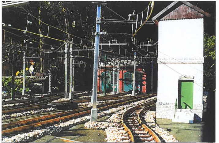
Perfekte Fahrleitung vor dem Heizhaus.
